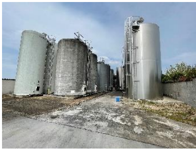
Photo n° 4 : Cuves extérieures de stockage de vins
